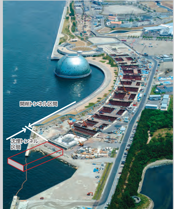
夢洲トンネル咲洲側アプローチの設計 Designed Sakishima approach of Yumesaki Tunnel
