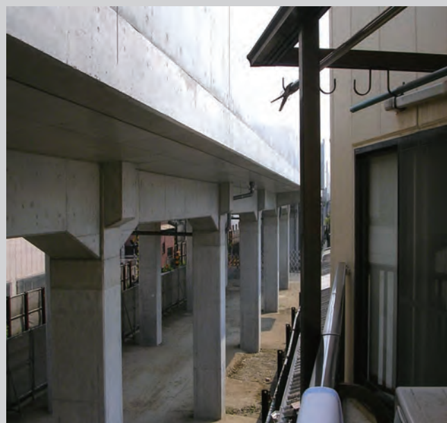
高架橋による日照補償のための調査 Compensation for sunshine obstruction caused by a viaduct
